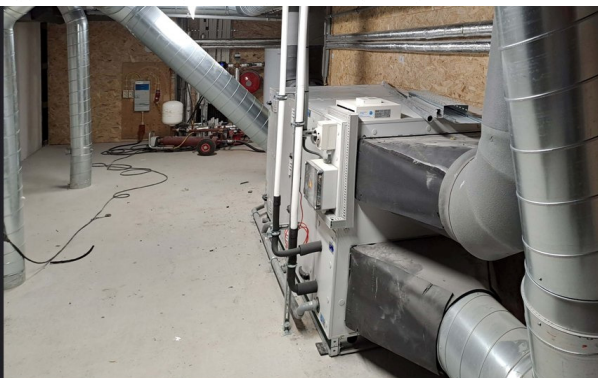
Technische ruimte met installaties
